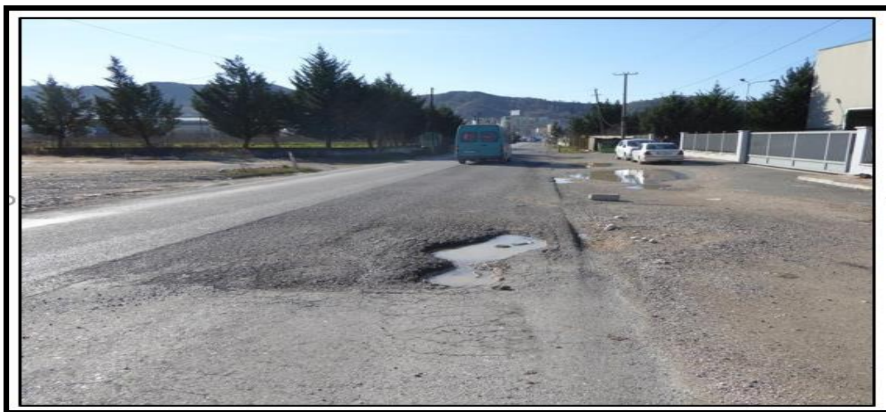
Figura 37. Gjendje e rrugës para ndërhyrjes për rehabilitimin dhe mirëmbajtjen.
